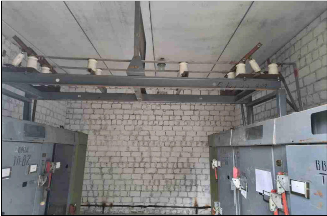
Секционная перемычка и секционный шинный разъединитель I и II секции шин ЗРУ 10 кВ ТП № 159
